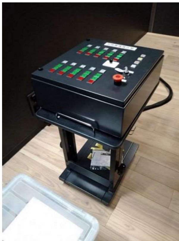
舞台吊物機構設備
