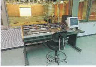
ホール音響照明設備
