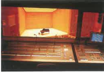
ホール音響照明設備
