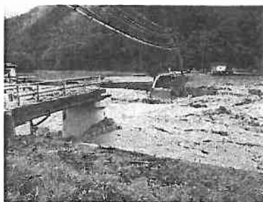
高山市清見町地内 河渡橋流失に伴う 添架農業集落排水施設管の流失
