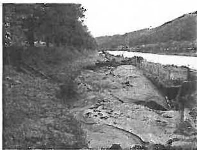
高山市国府町地内 桜野用水路 土砂流入
