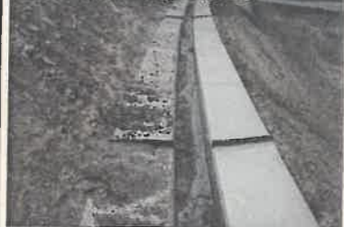
近景：法面の湧水発生状況
