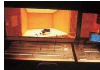
ホール音響照明設備
