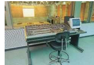
ホール音響照明設備
