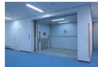
搬入用エレベーター
