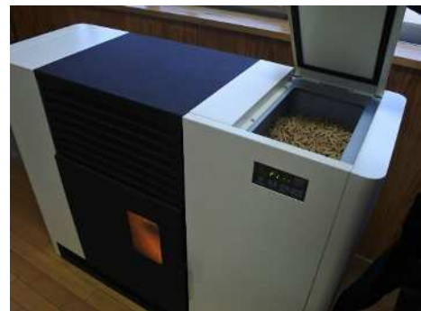
小学校に導入されたペレットストーブ （高山市）
