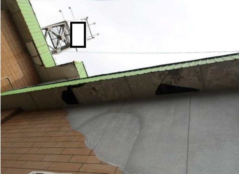
外壁天井の割れ（入口正面より撮影）
