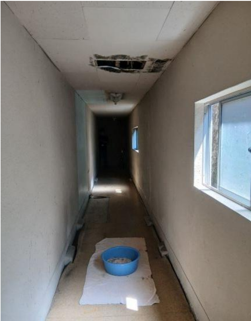
1 階廊下の天井。水漏れあり。
