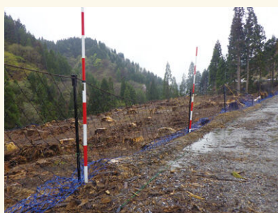
(写真②) 積雪により支柱がめり込み、柵の高さが低くなった状況
