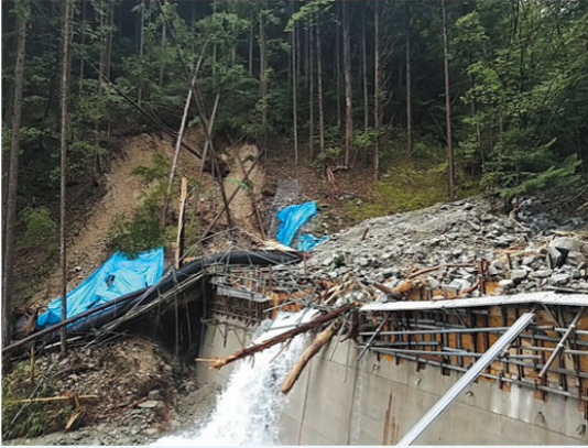
谷止工施工時の被災状況
