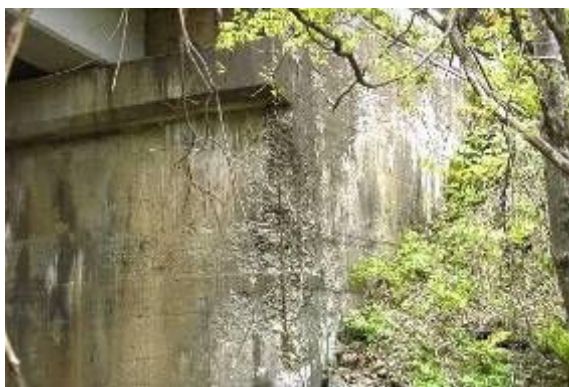
橋台端部が断面欠損している状況
