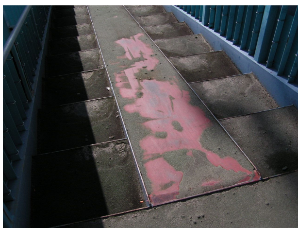
階段部の床鋼板の露出
