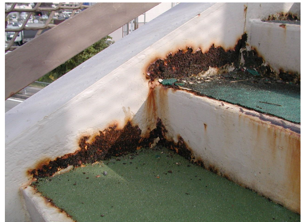
階段蹴上げ、踏み板の腐食
