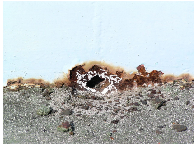
地覆表面からの連続的な腐食
