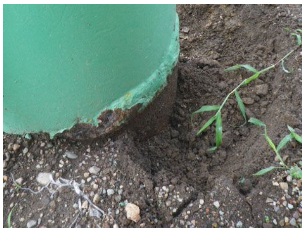
支柱基部の板厚減少
