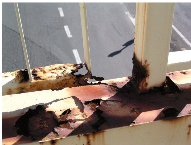
支柱、中貫および飾板の腐食
