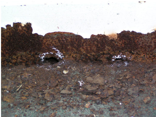
階段部地覆の腐食
