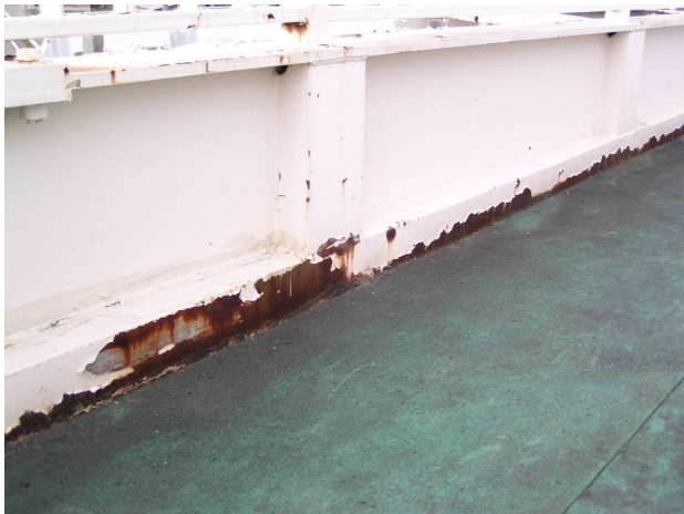
地覆表面からの部分的な腐食
