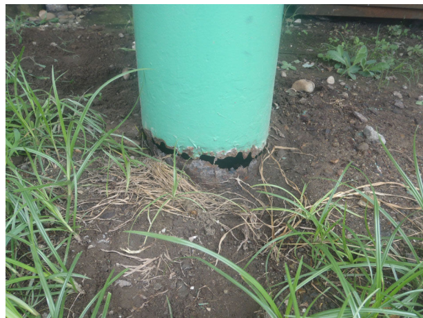
支柱基部の孔開き
