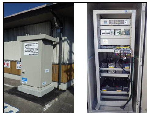
蓄電・配電装置
