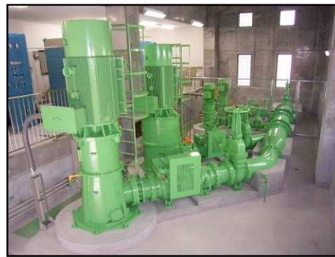
実施後（揚水機場内ポンプ）
