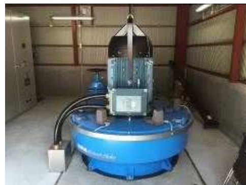
水車・発電機
