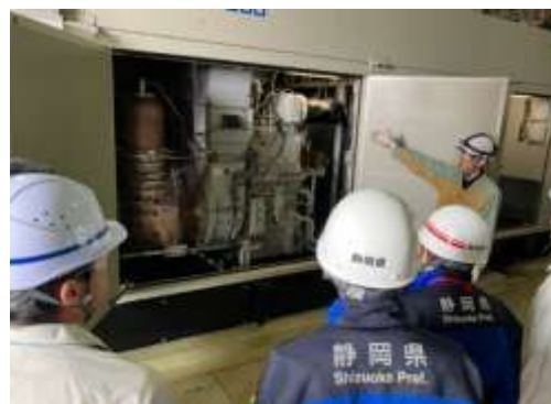
ガスタービン発電機を確認している様子
