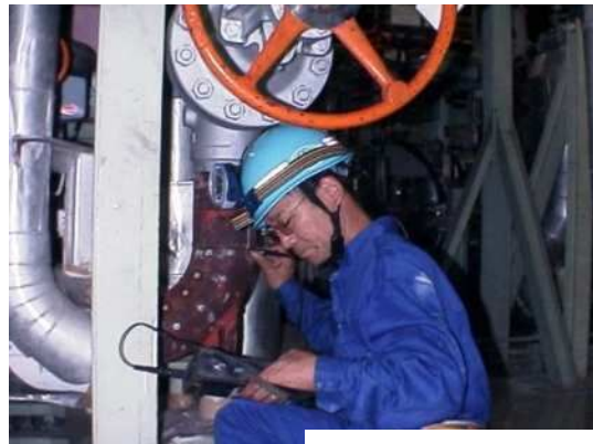
配管減肉の点検
