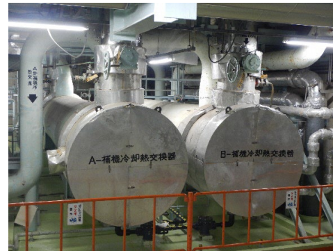
原子炉補機冷却熱交換器
