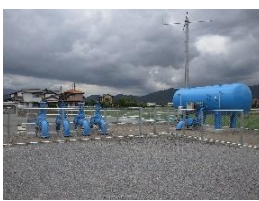
経営体 揚水機場
