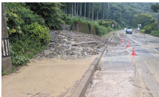
国道への土砂流出状況(本巢市佐原地内)
