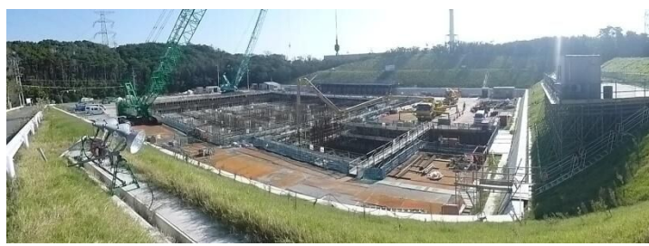
緊急時淡水貯槽
