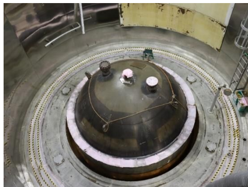
1号機RPVヘッド(取外し前)
