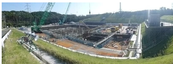
緊急時淡水貯槽
