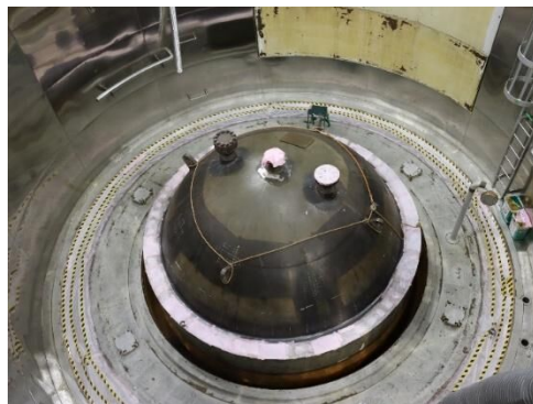
1号機RPVヘッド(取外し前)
