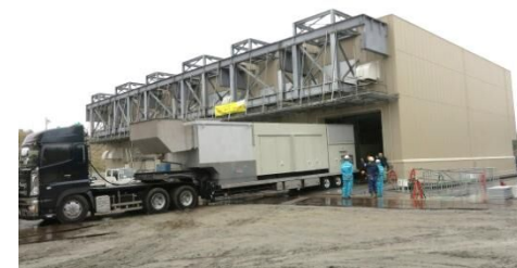
ガスタービン発電機
