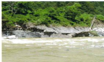
御母衣地内 護岸決壊
