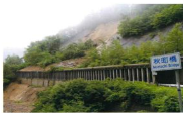
尾神地内 国道156号法面崩壊
