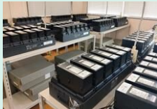
バッテリー保管・充電施設
