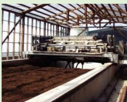
メタンの排出抑制、 良質な堆肥生産に資する 堆肥化処理施設
