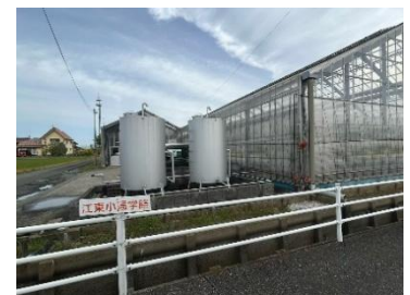
【花きハウス重油タンク】
