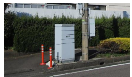
信号機電源付加装置
