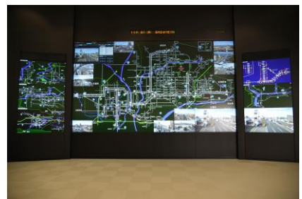
交通管制センター
