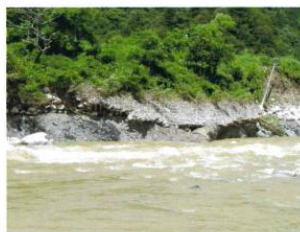
御母衣地内 護岸決壊
