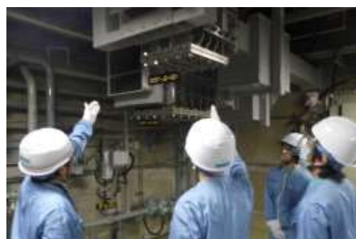
浸水防止ダンパの点検の様子
