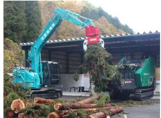
＜未利用材の加工施設＞
