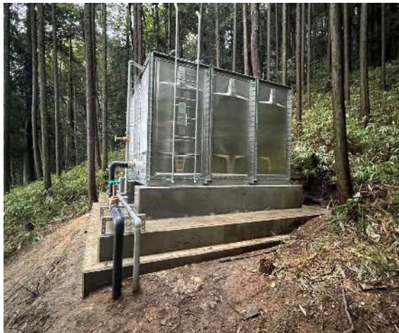
図 4-1-1 増設した給水槽
