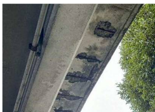
写真-2 損傷状況
