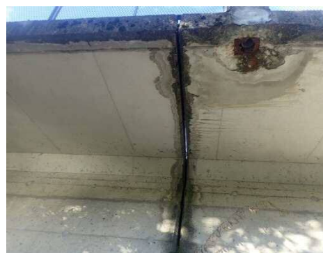
写真-2 損傷状況
