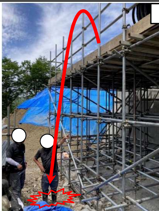
事故現場状況
