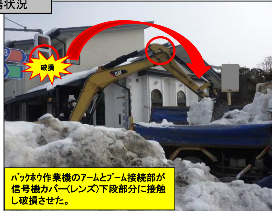
事故現場状況
