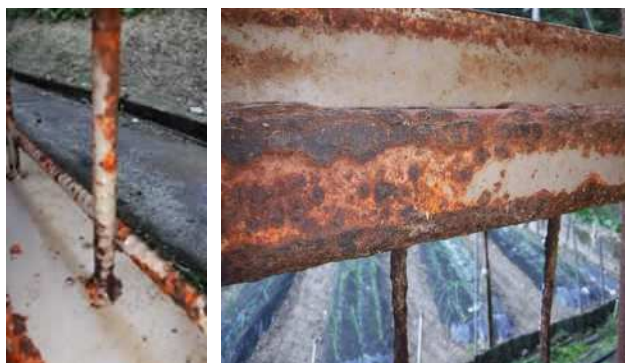
写真5：鉄柵が錆びて塗料が剥げている現状
