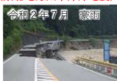
出典：岐阜県における主な被害状況等 （令和2年7月豪雨）（国道41号の被災状況）
