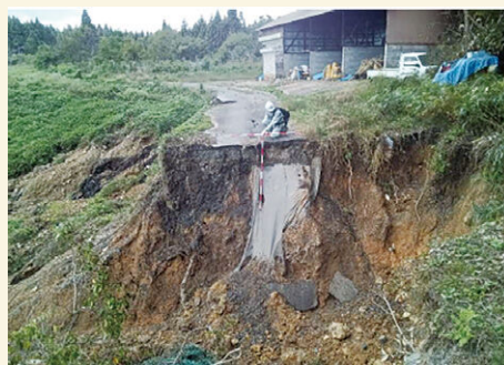
9月の豪雨により陥没箇所が消失した現場
