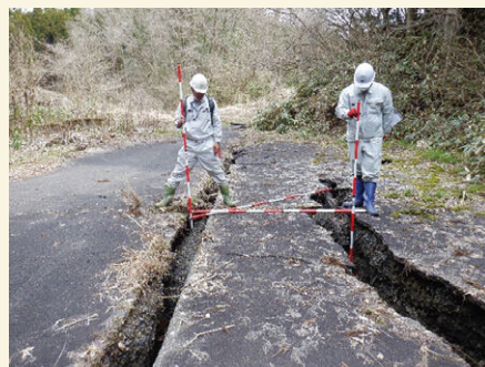
路面の亀裂等の被害の典型的な状況
