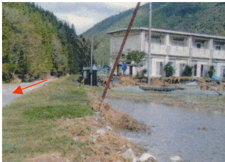
H16 馬瀬川(下呂市) 浸水状況
