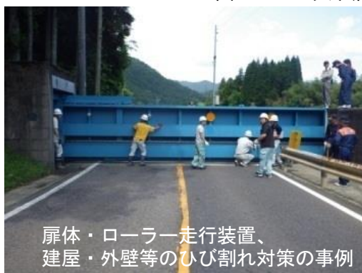
図- 1.29 妙見町陸閘の老朽化対策
