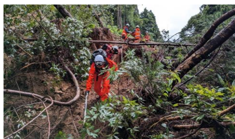
〔地震からの復旧現場での被災（中屋トンネル）〕
