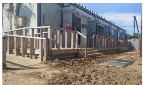
〔浸水した応急仮設住宅〕
