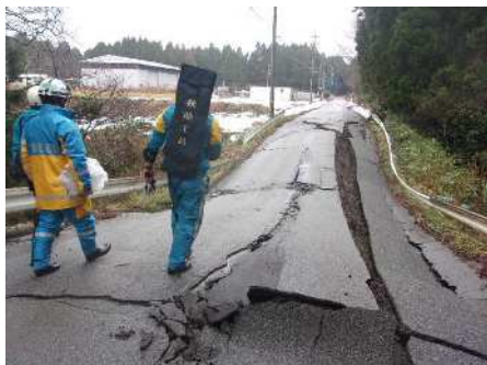
道路損壊状況
