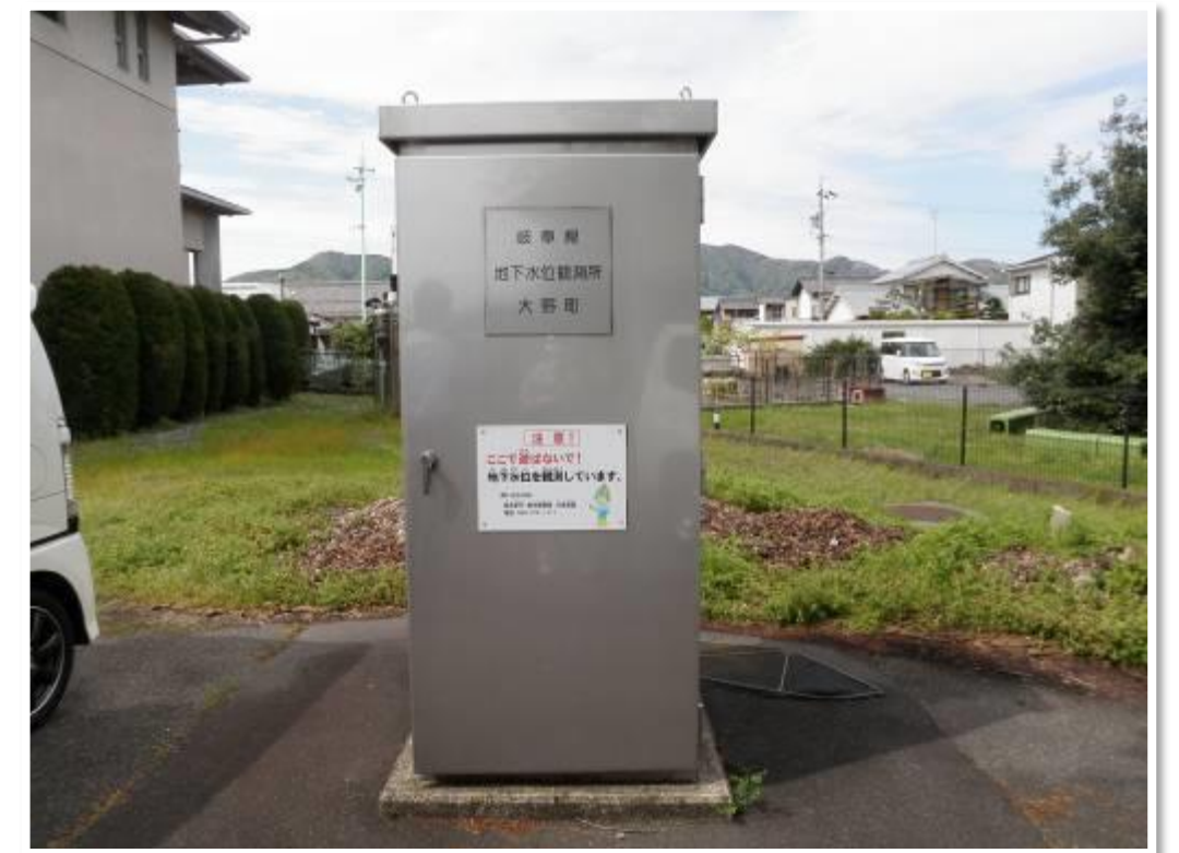
地下水位観測所
