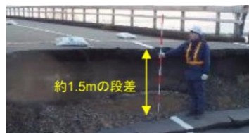
▲道路と橋梁の間で発生した段差 出典：国土交通省 令和6年能登半島地震道路構造物 （橋梁、土工、トンネル）の被害分析
