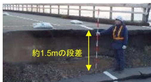
道路と橋梁の間で発生した段差
