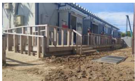
〔浸水した応急仮設住宅〕
