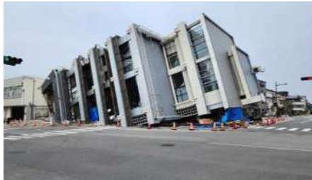
〔倒壊したビル〕
