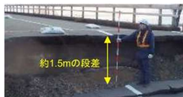
▲道路と橋梁の間で発生した段差
