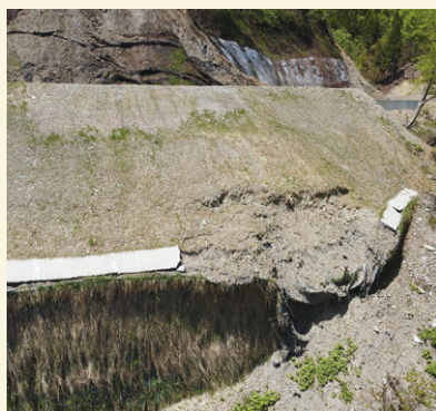
図1 天端部が破損した補強土壁 (令和4年5月 撮影)
