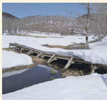
図3 雪庇により転倒した木道 (令和4年4月 撮影)
