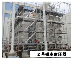
2号機主変圧器
