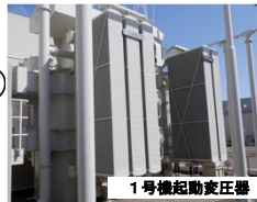
1号機起動変圧器
