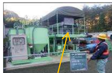
機械式脱水処理装置
