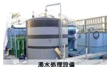
汚水処理設備
