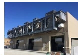
電源機能強化対策： 緊急時ガスタービン発電機
