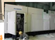
建屋内の発電機
