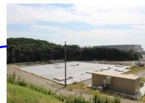
注水機能強化対策：緊急時淡水貯槽
