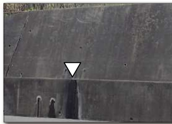
地下水の流出
