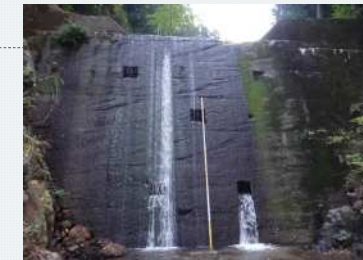
▲ 既設砂防えん堤の劣化状況 下の谷(揖斐川町)
