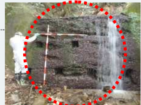
▲既設砂防えん堤の劣化状況 水油谷(海津市)
