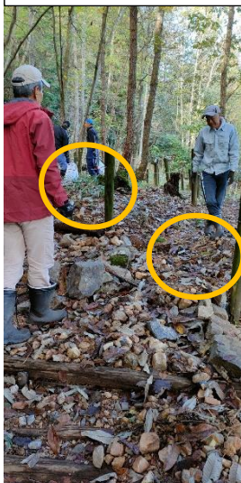
崩壊した路面
