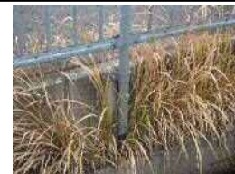
施工前 構造物の隙間から草が生えて
