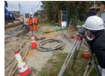
地盤の亀裂状況計測
