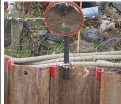
ミラー設置状況
